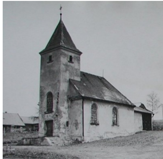
Obr. č. 6: Kostel sv. Josefa před rekonstrukcí,
